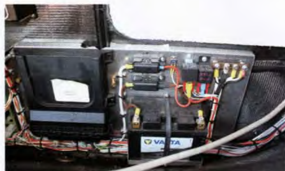
Sempre nel vano posteriore troviamo le centraline e la batteria di backup da 12V
